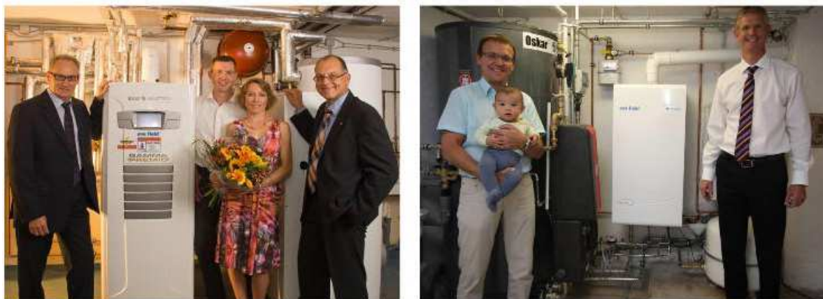
Figure 5 - Les deux premiers cogénérateurs Ene.field installés en 2013
