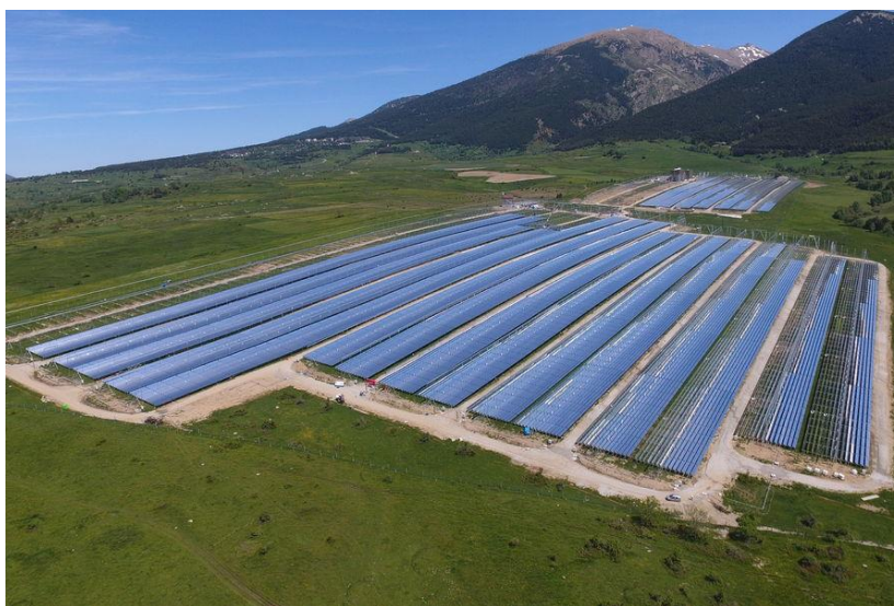
Figure 9 - La centrale solaire thermodynamique à miroirs de Fresnels de Llo (Pyrénées Orientales)
