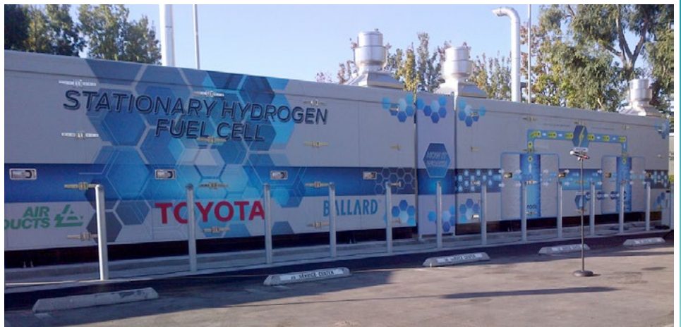
■ Pile Ballard de 1,1 MW installée chez Toyota Motor Sales USA en 2012
