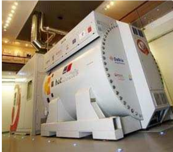
Figure 4 - La pile MTU à l'OPAC de la Porte Brancion (Paris - 2003)
